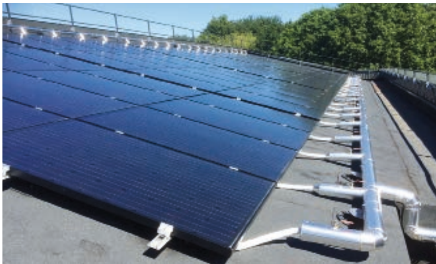
Les toitures sont couvertes d'un champ de 1 037 m 2 de panneaux hybrides.
